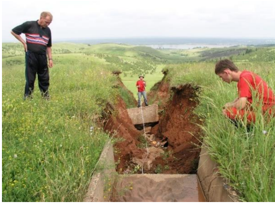
Рис. 7. Вершина активного оврага с разрушенными бетонными лотками на правом крутом склоне долины р. Кама у с. Соколовка Сарапульского района УР
