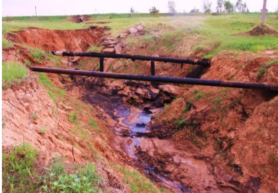
Рис. 6. Последствия катастрофического роста придорожного оврага ниже водопропуска весной 2011 г. у с. Тарасово Сарапульского района УР
